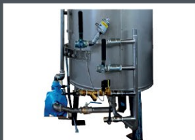
Gruppo valvole con pompa
